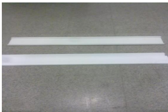
Detalle tapa de registro y aislante
